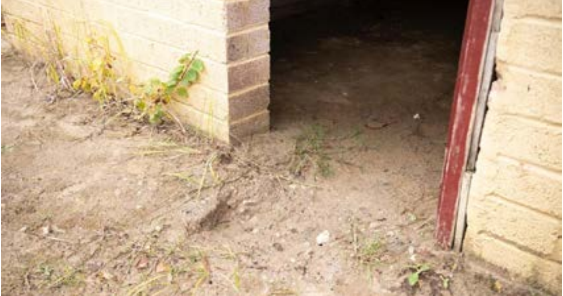
الصورة 71: يمكن أن تتواجد الأوضاع الرخوة في المباني
