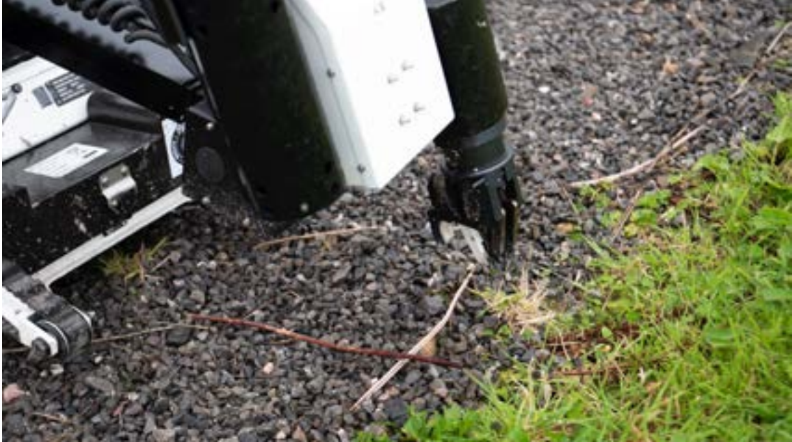
الصورة 3: مركبة يتم تشغيلها عن بُعد وتُحدّد موقع الوصلة الكهربائية
