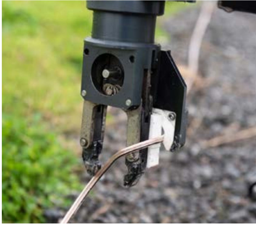
الصورة 4: مركبة يتم تشغيلها عن بُعد تقطع وصلة كهربائية عن بُعد جزئياً
