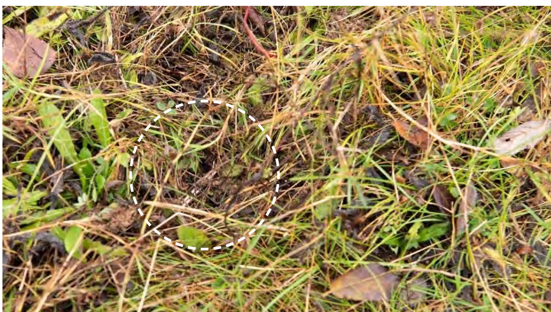
Image 35. Câble de commande repéré grâce à un changement de couleur au niveau de la régularité observée sur les images 33 et 34.
