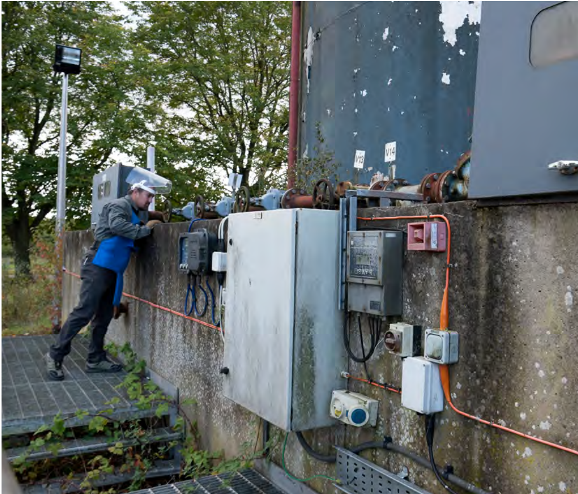
Image 15. Sur cette image, les dangers incluent le combustible en vrac, l'énergie haute tension et un réservoir d'eau fermé. Notez que la visière de l'opérateur est relevée temporairement pour faciliter l'observation visuelle
