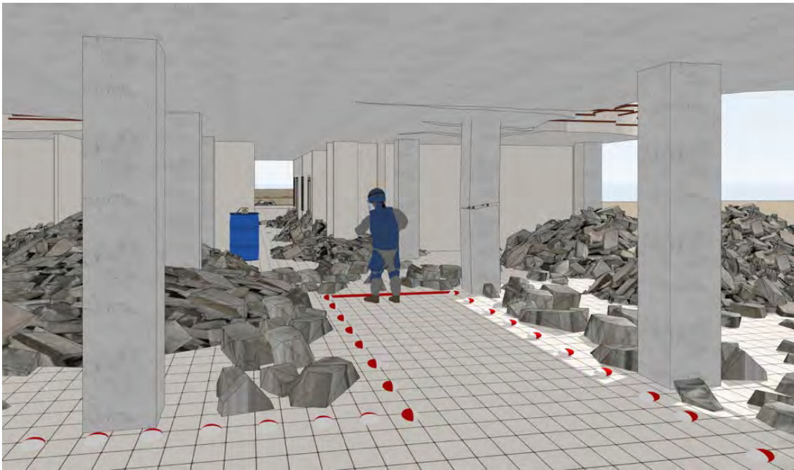
Image 16. Dépollution manuelle de gravats dans un environnement multi-dangers (explosifs et non explosifs)
