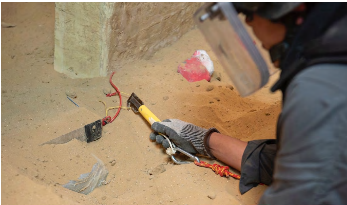
Image 20. Positionnement du cutter de façon semi-éloignée contre un seul fil du détonateur. (Le câble rouge est une élingue)
