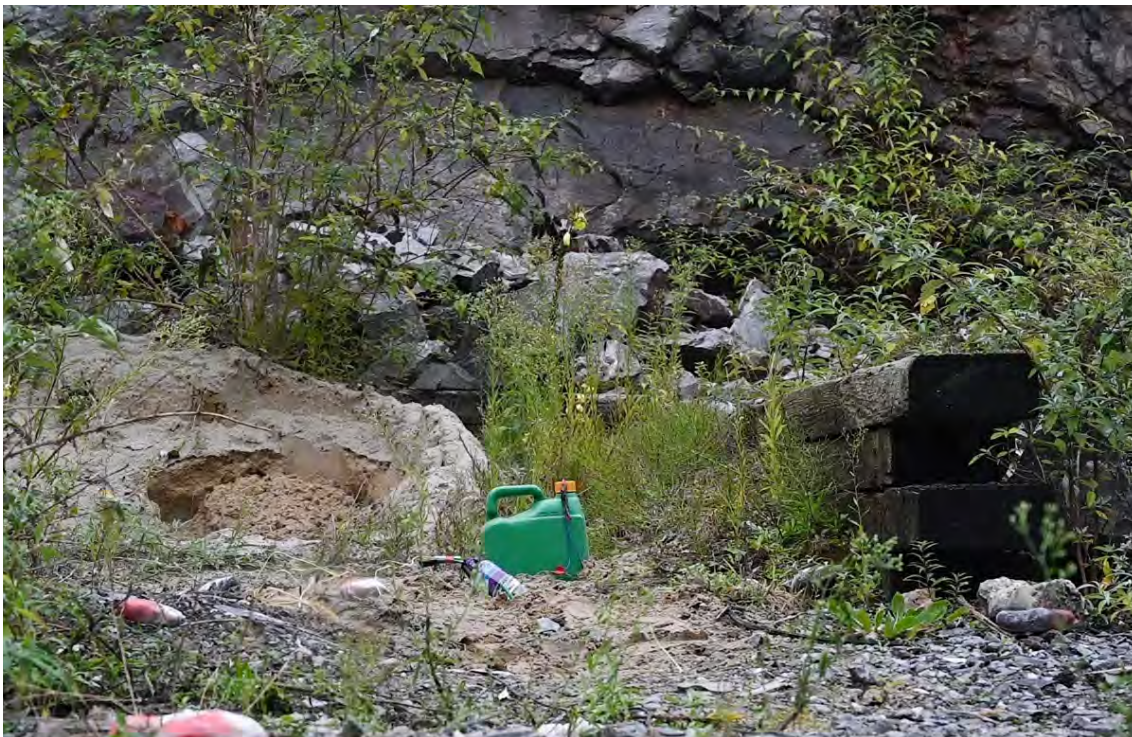
Image 16. Disrupteur in situ avant d'être déclenché depuis le point de contrôle
